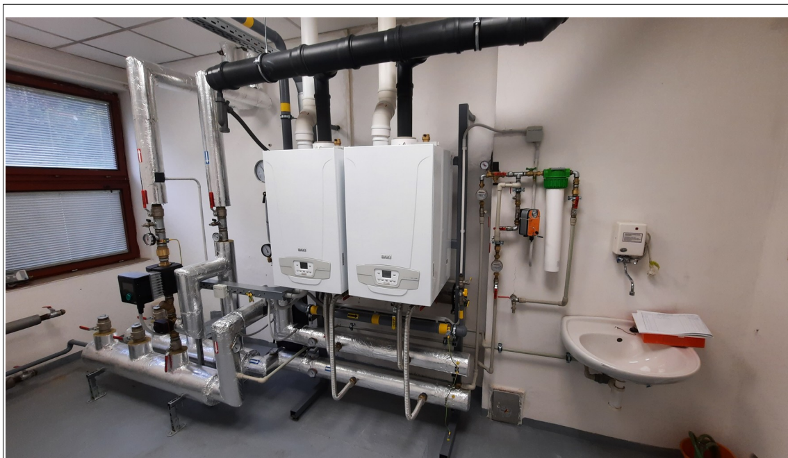
Nová zkolaudovaná kotelna v č.p. 362
